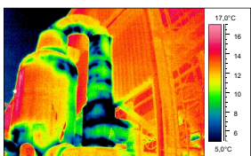
Chemieanlage: Fehler in der Kälteisolierung
